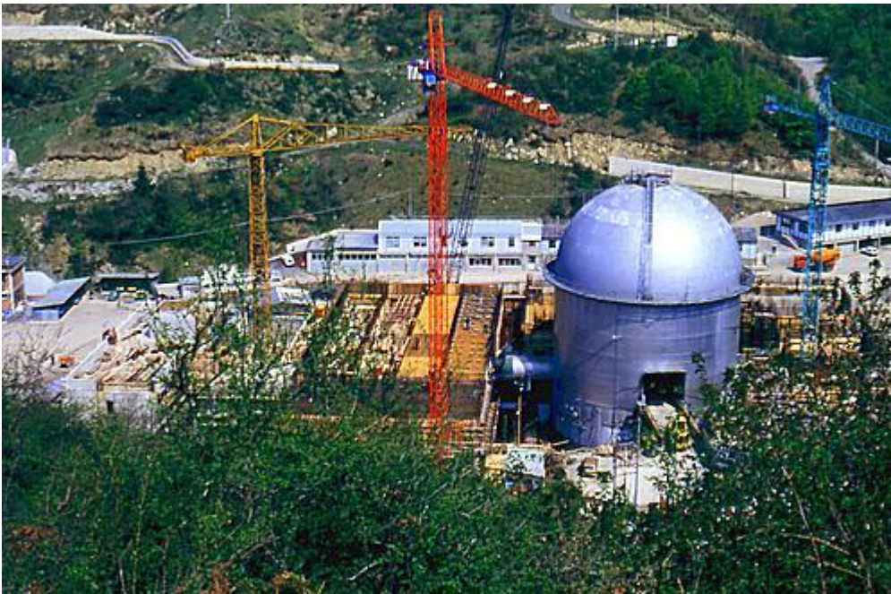
La centrale nucleare sul lago Brasimone, vicino a Castiglion dei Pepoli (BO), mai completata.
